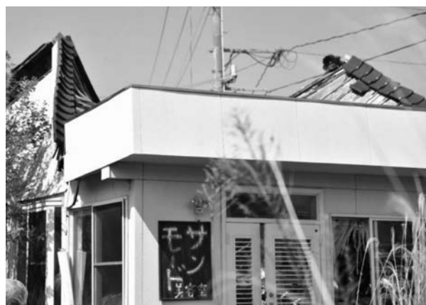
美容室の屋根は完全に落ちている
